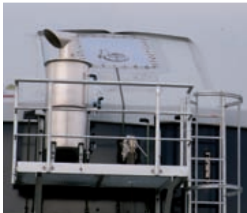
Hydraulische Über- und Unterdrucksicherung bis 4.000 m 3 /h DEKRA-geprüftes System
