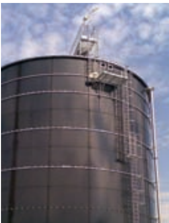
Fermenterbegehung über eine Aufstiegsleiter Wartungsbühne an den Schaugläsern
