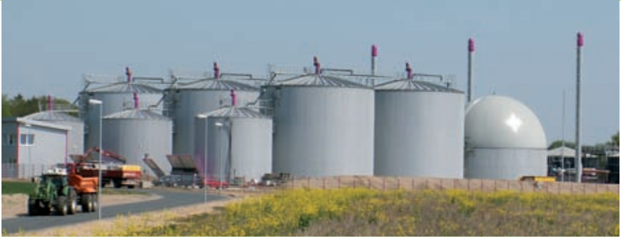
Biogasanlage Trelder Berg, 21244 Buchholz i.d. Nordheide. 6 Fermenter à 3.750 m 3 mit Zentralrührwerk
