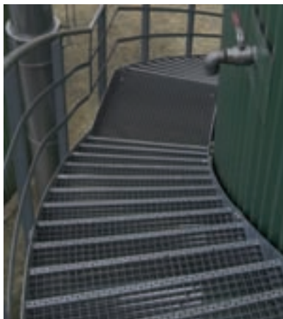
Umlaufende Tankmanteltreppe zur Behälterbegehung in verzinkter Ausführung
