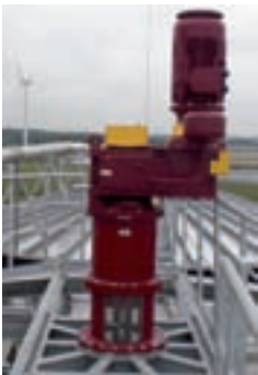
Rührwerksantrieb und -lagerung
