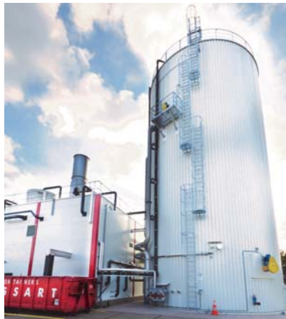
Veghel, Niederlande, Baujahr: 2014 MBBR 1.250m 3 Ausrüstung: V4A-Druckdach, Isolierung, Stahlbau, Rohrleitungsb.
