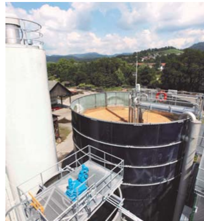
Gengenbach, Baujahr 2007 MBBR 815m 3 Ausrüstung: Stahlbau Besonderheit: Bauseit. Mittelrohr
