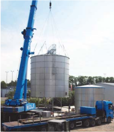
Dorsten, Baujahr 2010 MA-Becken 210m 3 Anaerobreaktor 809m 3 Besonderheit: Edelstahlboden
