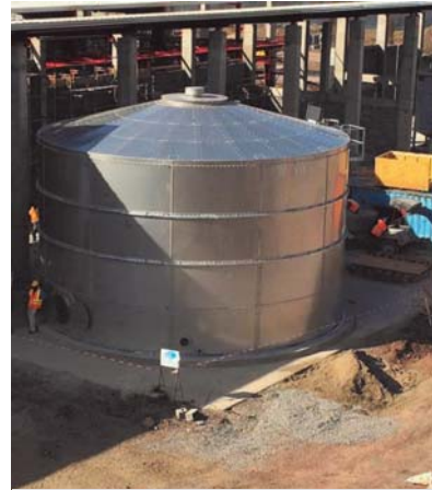
Adis Abeba, Äthiopien, Bauj. 2013 Trinkwasserbehälter 450m 3 Ausrüstung: V4A-Dach, Stahlbau, PEHD-Boden
