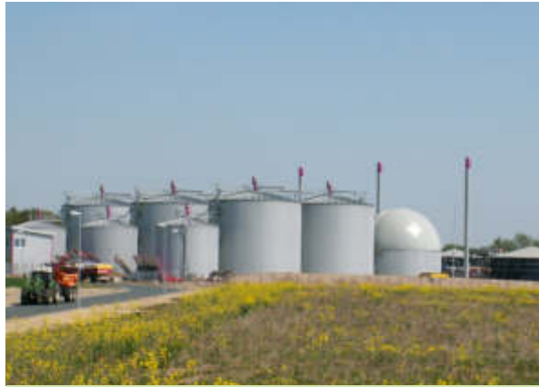
Energiepark Trelder Berg 6 Fermenter mit jeweils 3.860m 3 Trelder Berg Energy Park 6 fermenters, each with a capacity of 3,860 m 3 .
