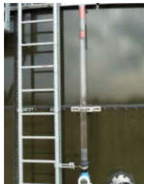
Kontinuierliche Füllstandsmessung des Gasspeichers
