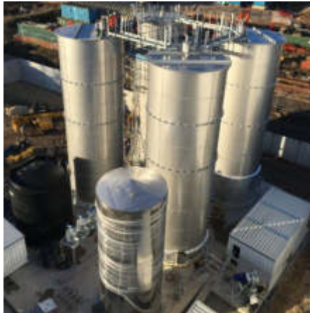
Hydrolysebehälter Hydrolysis tanks
