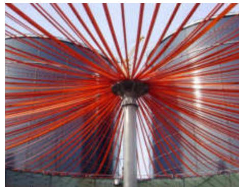
Edelstahlmittelstütze und Gurtunterkonstruktion
