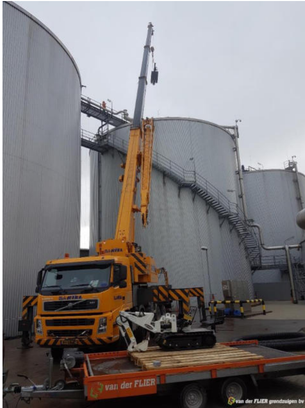
Demontage Rührwerksluke Kronring Fermenter Einhub eines Minibaggers / Lifting in a mini digger through opening at centre
