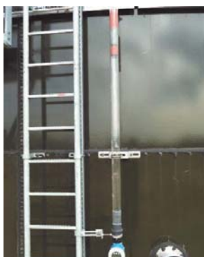
Kontinuierliche Füllstandsmessung des Gasspeichers
