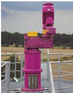
Rührwerksantrieb und -lagerung
