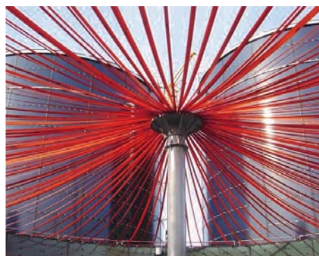
Edelstahlmittelstütze und Gurtunterkonstruktion
