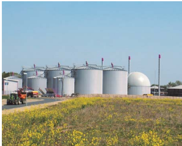
Energiepark Trelder Berg 21244 Buchholz i.d. Nordheide Baujahr 2006 / 2010 6 Fermenter mit jeweils 3.860m 3
