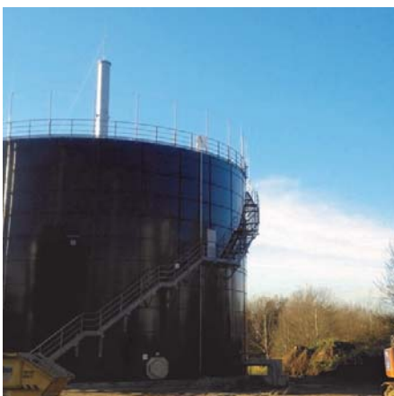
Kläranlage Bremen Seehausen Niederdruckgasspeicher 50 mbar Volumen: 5.000 m 3
