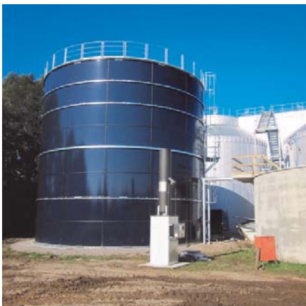
Kläranlage Nordhorn Niederdruckgasspeicher 50 mbar Volumen: 1.000 m 3
