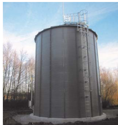
Kläranlage Halle Druckloser Speicher Volumen: 384 m 3
