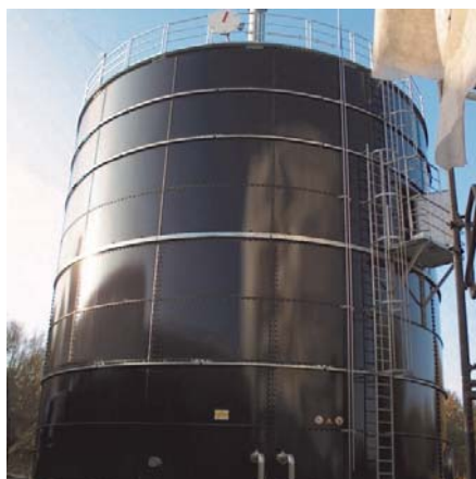
Kläranlage Rietberg Niederdruckgasspeicher 50 mbar Volumen: 1.000 m 3
