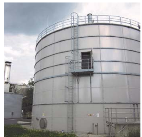
Kläranlage Wiesbaden-Biebrich Niederdruckgasspeicher 45 mbar Volumen: 2.500 m 3
