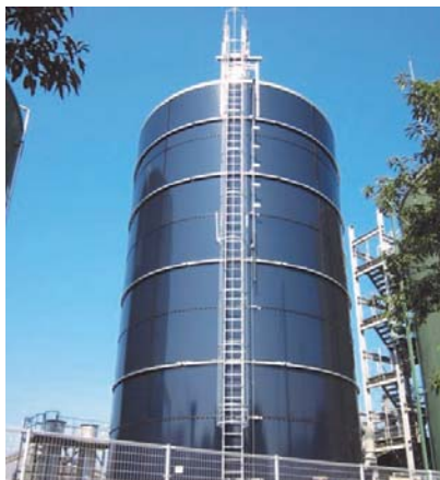
Kläranlage Nantan (Japan) Druckloser Speicher Volumen: 500 m 3
