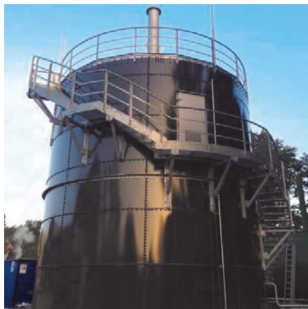
Kläranlage Trittau Niederdruckgasspeicher 30 mbar Volumen: 250 m 3
