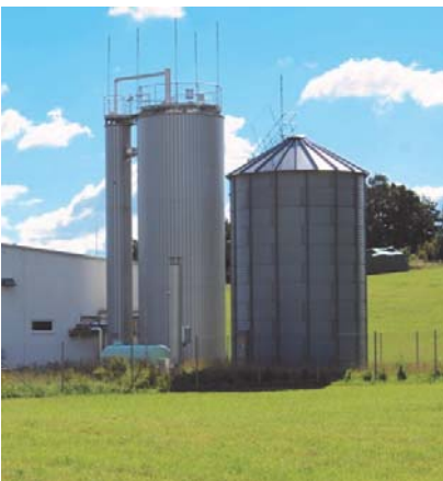
Kläranlage Vestenbergsgreuth Druckloser Speicher Volumen: 200 m 3
