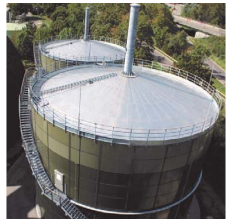
Zentralklärwerk Mainz Niederdruckgasspeicher 55 mbar Volumen: 2.500 m 3 und 3.700 m 3
