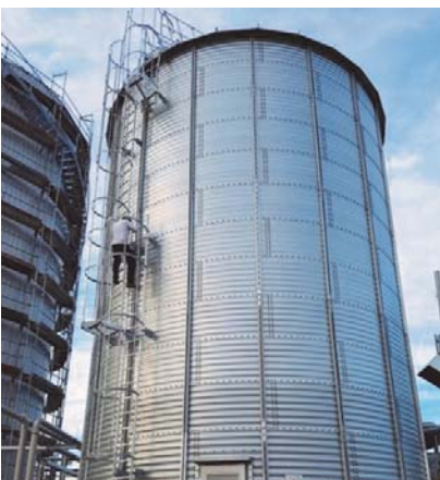
Kläranlage Übach-Palenberg Druckloser Speicher Volumen: 250 m 3
